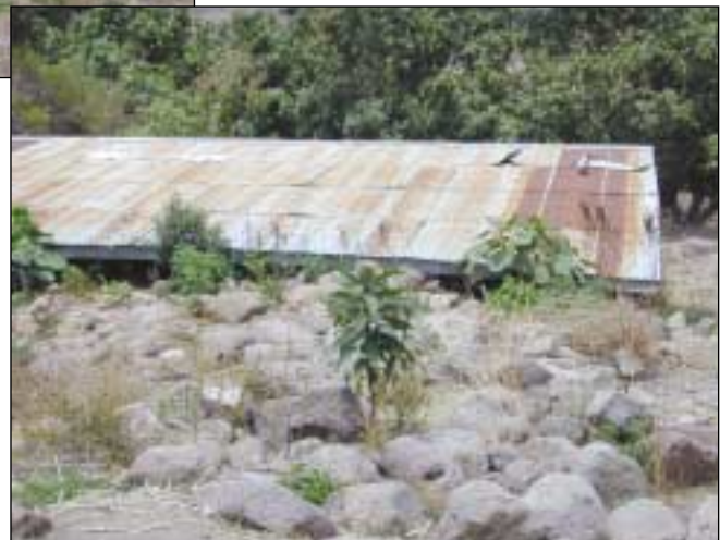
Figure 5. Estructuras destruidas por los flujos de escombros detrás del hospital de La Trinidad.
