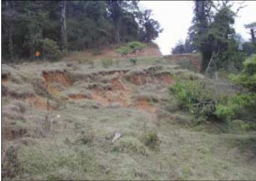
Figura 7. Flujo de tierra profundo, de lento desplazamiento, en el camino a Jinotega. El camino que atravesaba este accidente quedó interrumpido en varios sitios y fue sometido a una reparación total.
