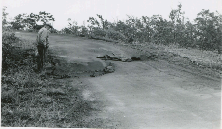
25 Nov 1965 Cracks / Mauna Iki Trail / Nelinea Lali Road - Ha Pavers
